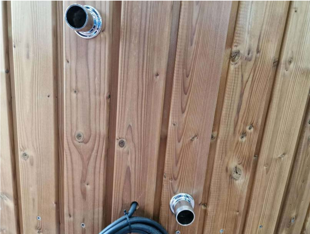
Abbildung 26: Darstellung des 230 V-Schuko-Steckers des Hot Tubs (rechts daneben: Vorbereitung für die Sandfilteranlage (Wasser-Rücklauf zur Sandfilteranlage)) aus rostfreien V4a Anschlüssen
