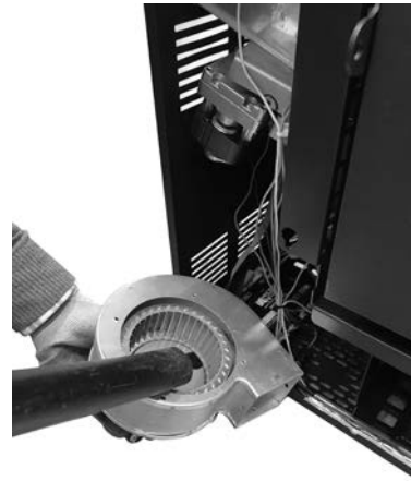
Fig. 71 - Reinigung des Raumventilators
